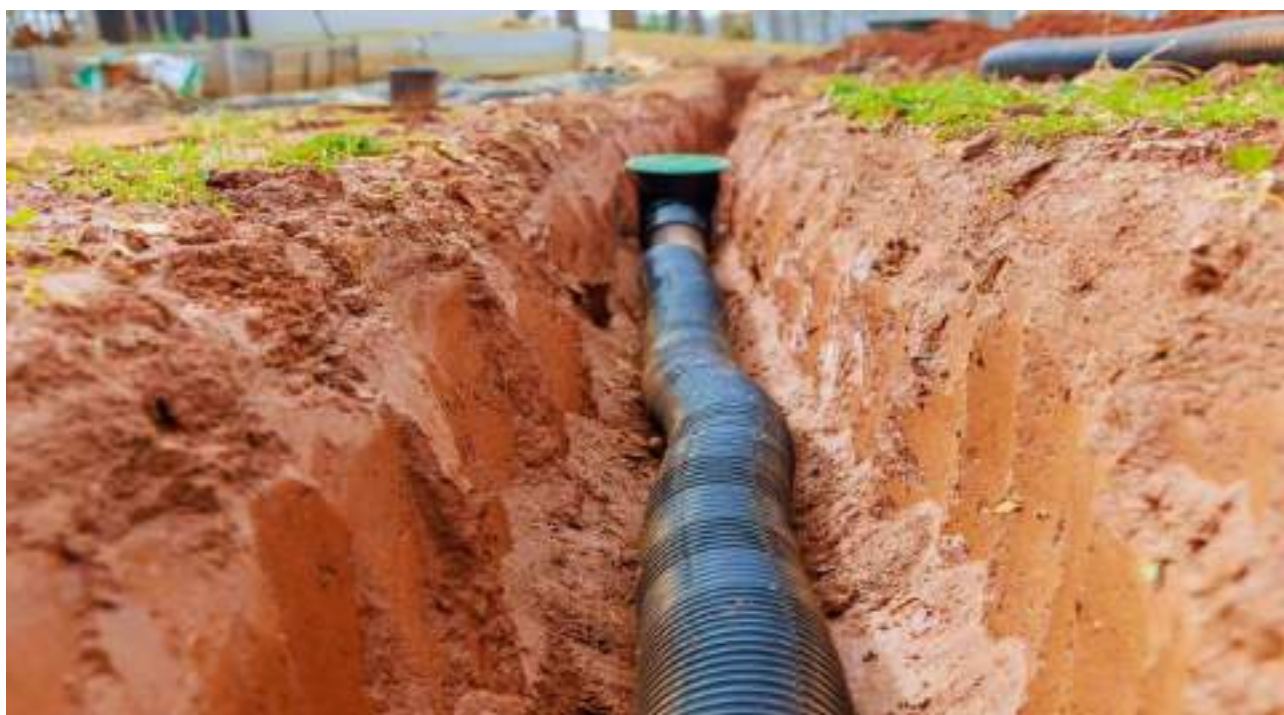
Sistema de drenagem de águas pluviais na cidade.
